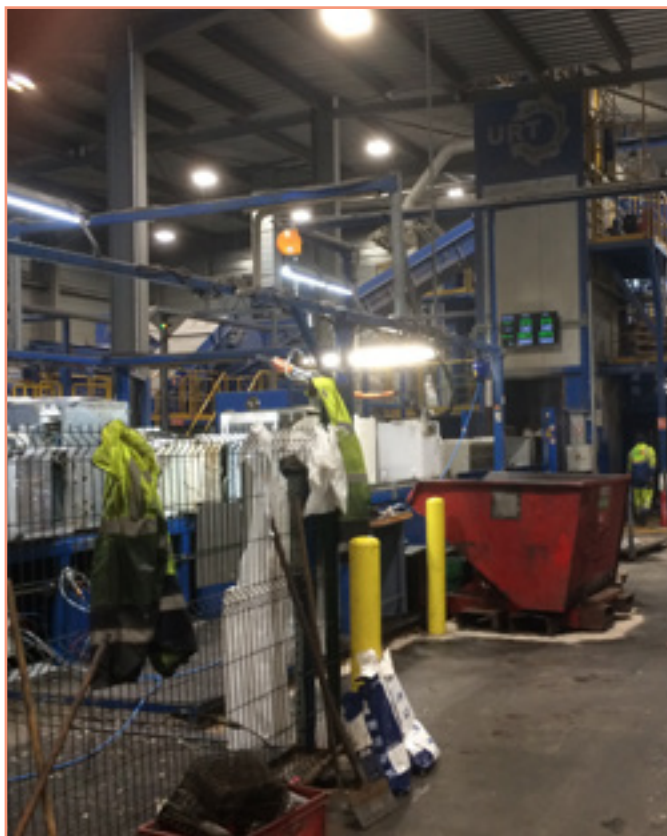
Фото 1. Линия по переработке холодильного оборудования на предприятии SITA DEEE
